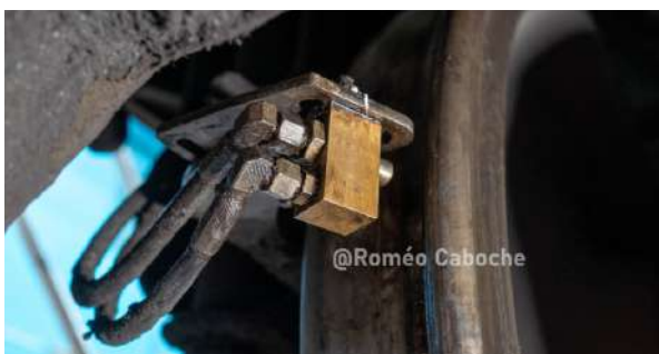
Un graisseur de boudin en place dans son état sauvage, sous la rame.
